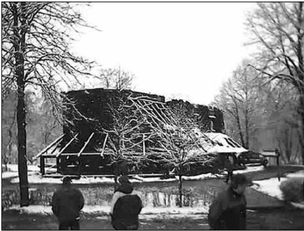
II. 6. Widok pozostałości kościoła po drugim pożarze w roku 2002 [1]
